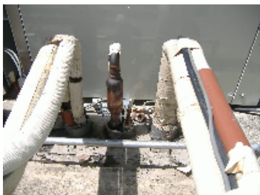
着火源となった溶接箇所
