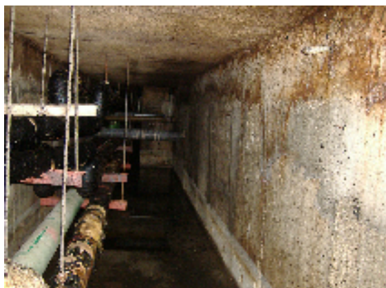
LPガスが滞留した地下ピット
